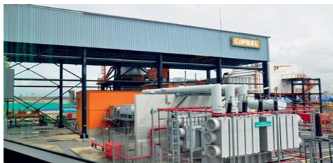
CIPRELコンバインドサイクルガス発電所（同社提供）
